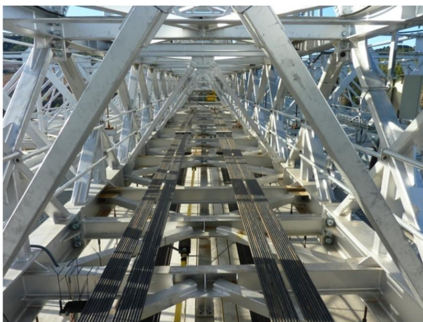
Fig. 2.13 – Cabos do sistema OPS na viga principal [14].
