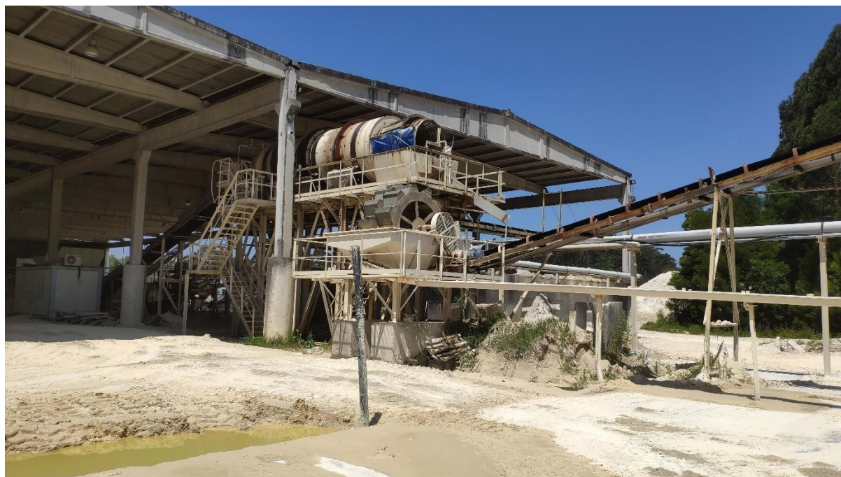
Figura 13 - Instalação de tratamento de caulinos em estudo
