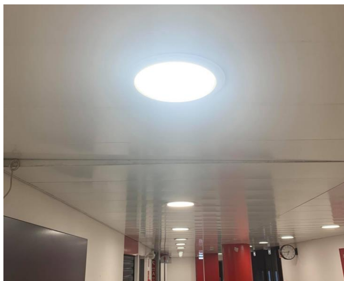
Figura 5.22 - Iluminação do corredor
