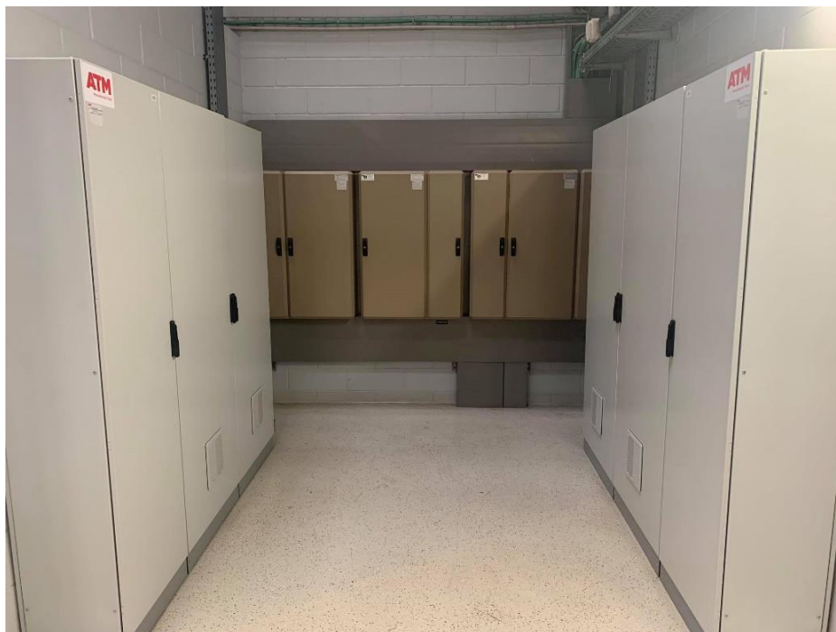
Figura 5.13 – Aparelhagem do sistema de energia
