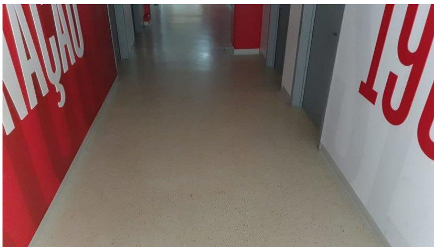
Figura 5.8 - Piso corredor do Pavilhão Nº2
