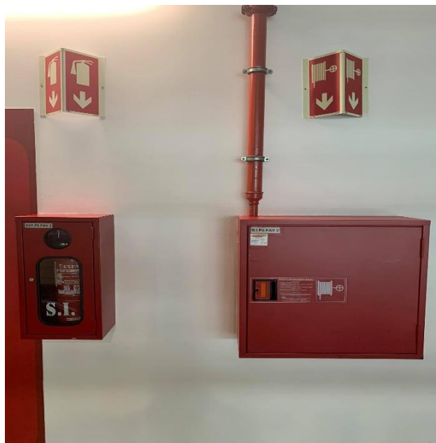
Figura 5.14 - Equipamentos de segurança contra incêndios do Pavilhão N°2
