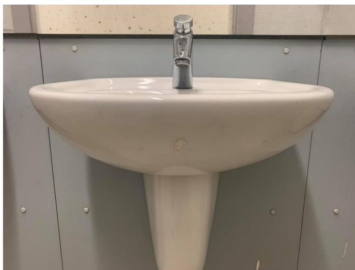
Figura 5.11 - Comando de abastecimento de água da zona de público
