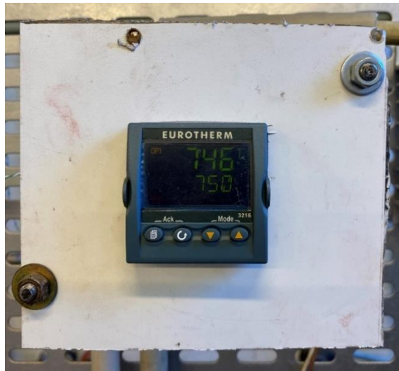
Figura 6.15 - Controlador de temperatura do leito.
