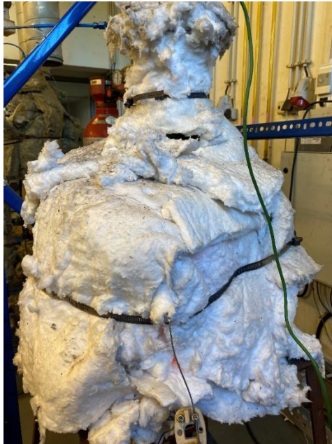
Figura 6.13 - Leito isolado com fibra de cerâmica Kaowool .
