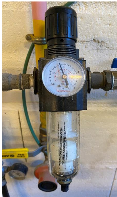
Figura 6.19 - Válvula redutora de pressão.
