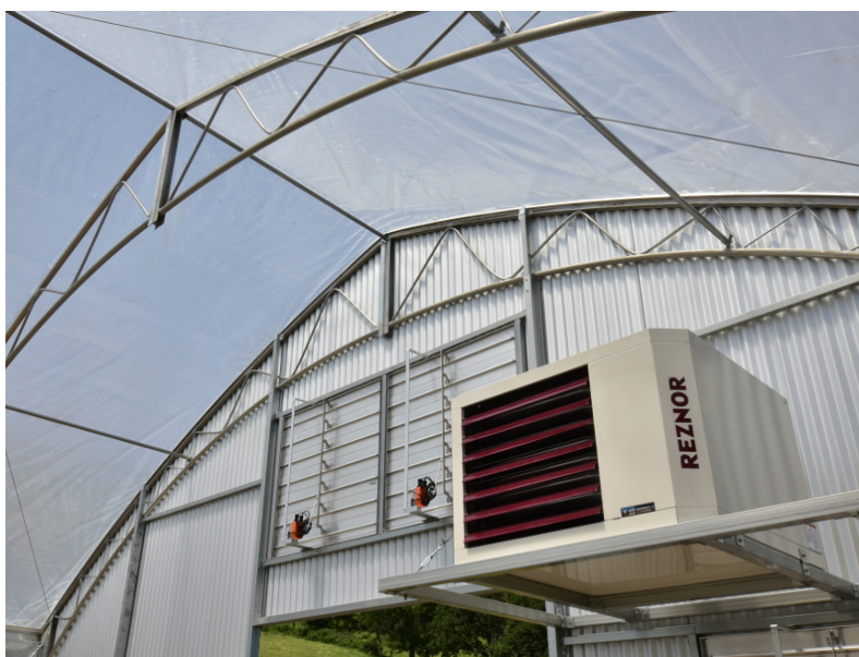
Figura 2.2: Aquecimento individual por queima (Evolve Greenhouse Systems, Junho 2020)
