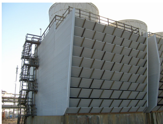
Figura 3.9: Grelhas de entrada de uma torre de arrefecimento (Cooling Tower Depot, Abril 2020)
