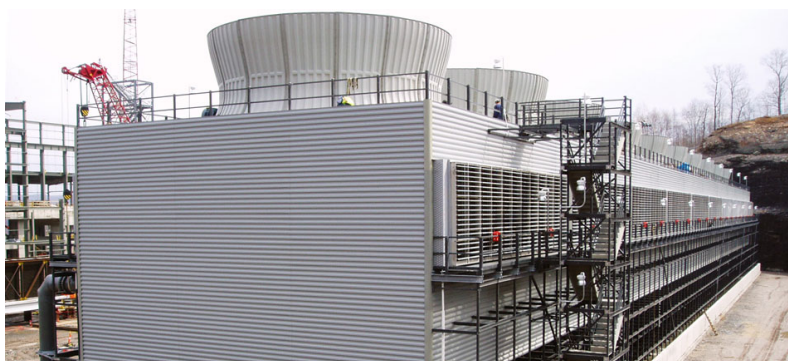
Figura 3.4: Carcaça de uma torre de arrefecimento (Amertech Tower Services, Abril 2020)
