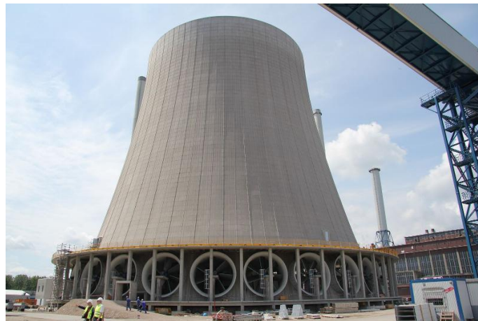
Figura 3.15: Torre de arrefecimento hiperbólica com ventilação assistida (HAMON, Abril 2020)
