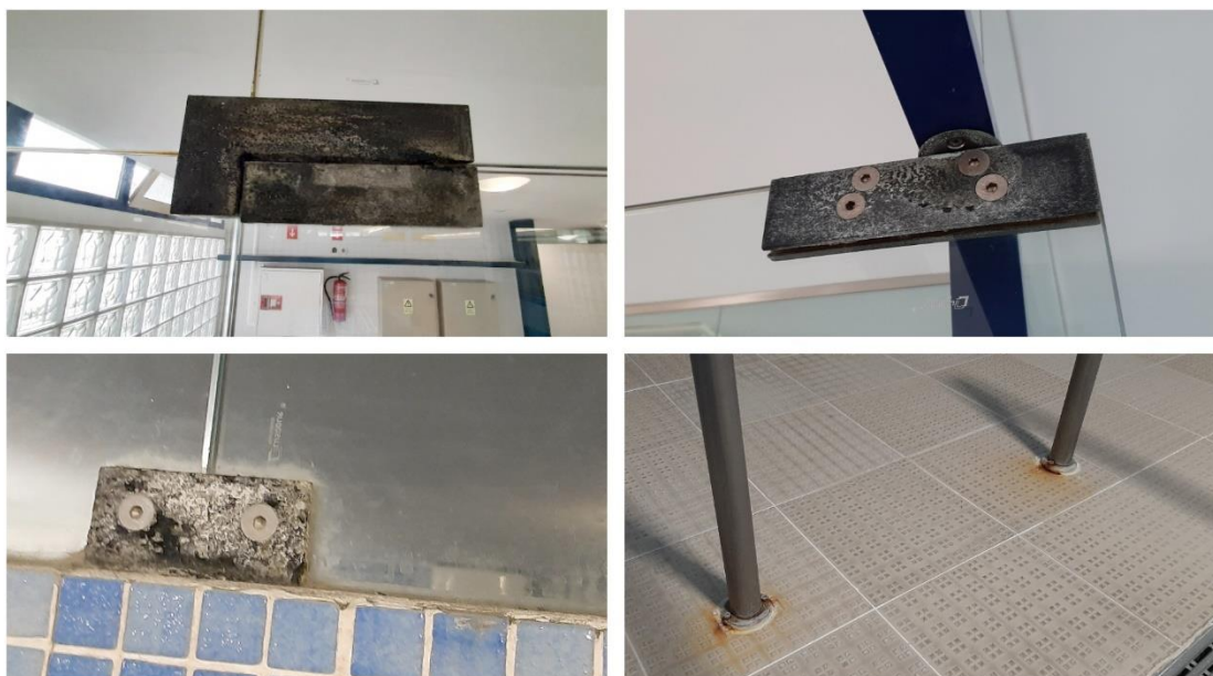
Figura 3.35 – Exemplos de corrosão em peças metálicas
