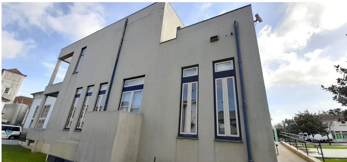
Figura 3.33 – Tubos de queda apresentando descasque de tinta
