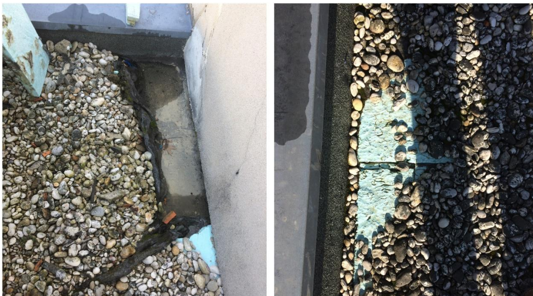
Figura 3.37 – Anomalias variadas na cobertura plana (07/02/2019 – cortesia Eng. Diogo Oliveira)
