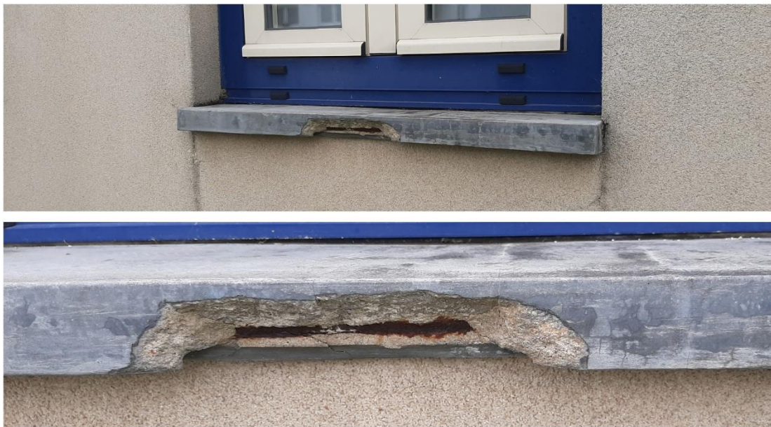
Figura 3.20 – Armadura do peitoril exterior à vista
