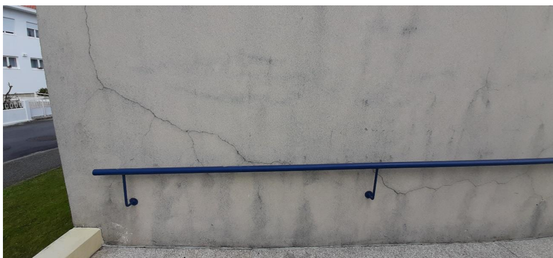
Figura 3.8 – Fissura no revestimento exterior
