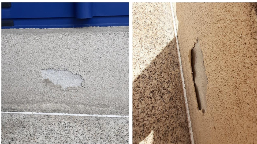
Figura 3.12 – Destacamento do revestimento
