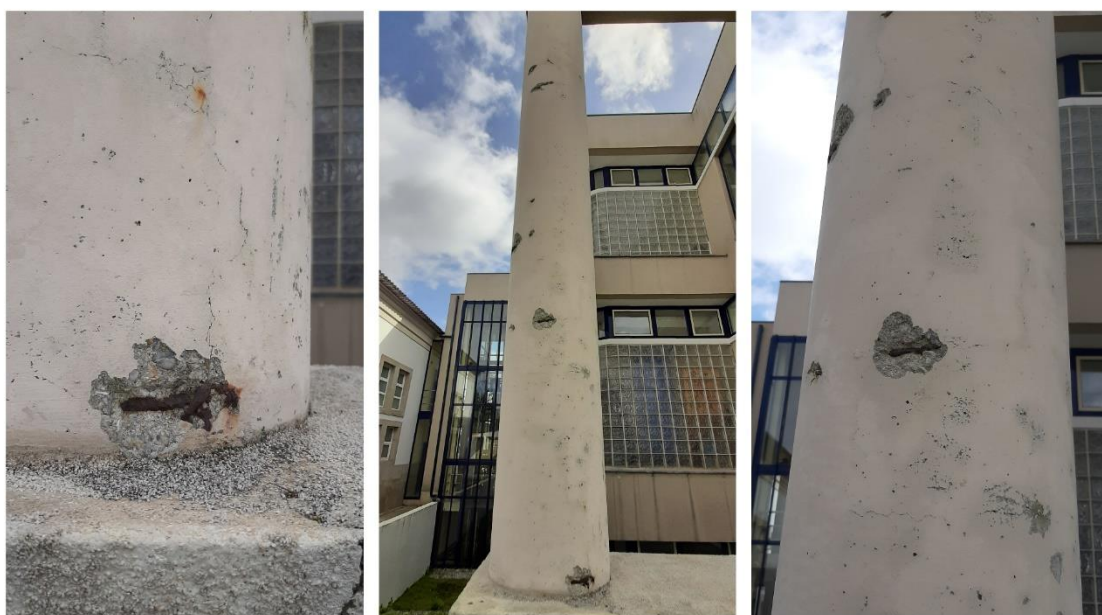
Figura 3.18 – Destacamento do betão
