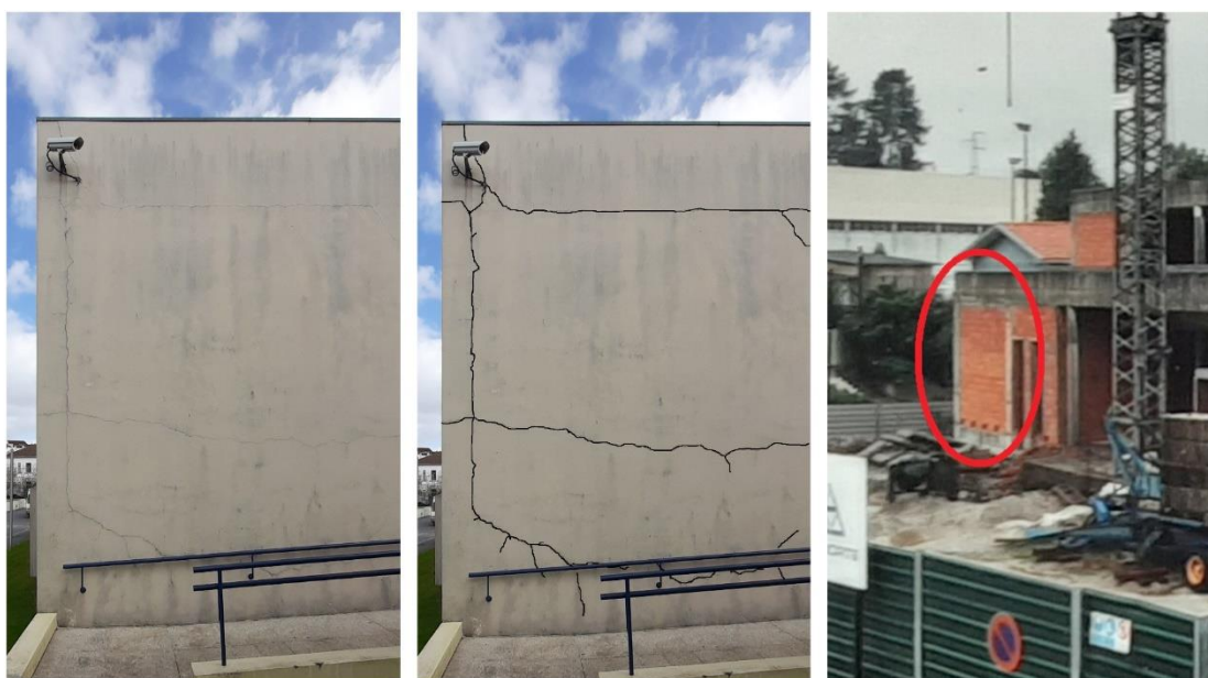
Figura 3.9 – Exposição da possível causa (fotografia da obra - cortesia Dra. Lúdia Melo)
