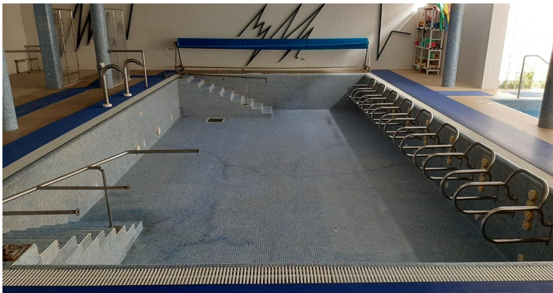
Figura 3.26 – Fissura no fundo da piscina (11/05/2020)
