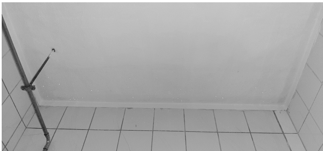
Figura 3.2 – Gotas de água no teto (compartimento do pessoal da limpeza)
