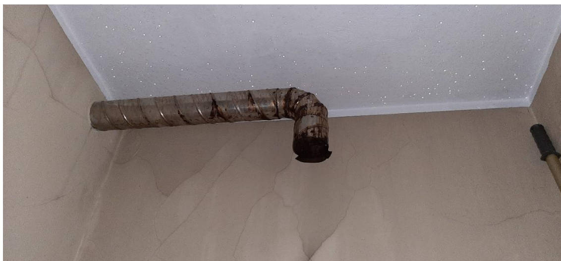
Figura 3.3 – Gotas de água no teto (compartimento de arrumos)
