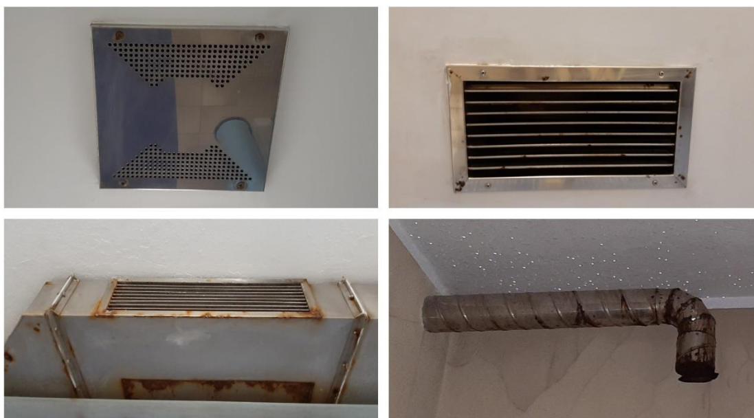
Figura 3.36 – Exemplos de corrosão em condutas e grelhas situados na cave
