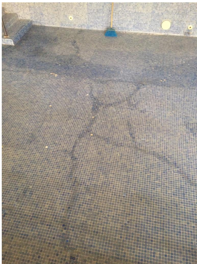
Figura 3.27 – Fissura no fundo da piscina (07/02/2019 – cortesia Eng. Diogo Oliveira)
