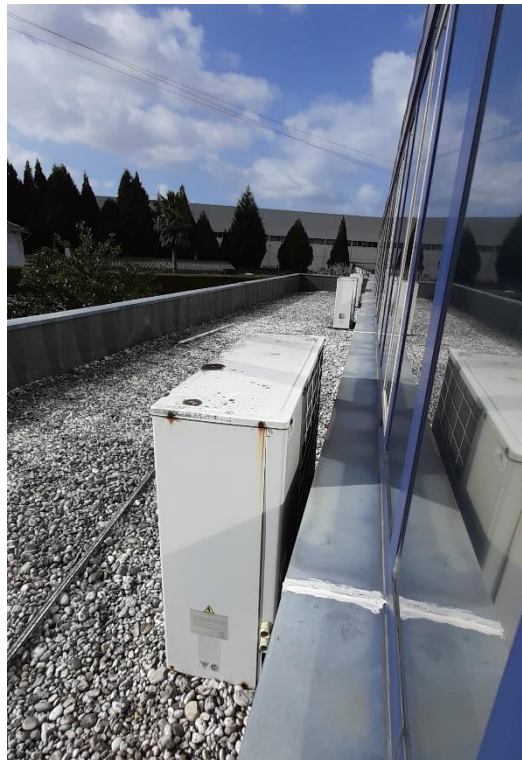
Figura 3.34 – Equipamentos de ar condicionado da sala de ORL
