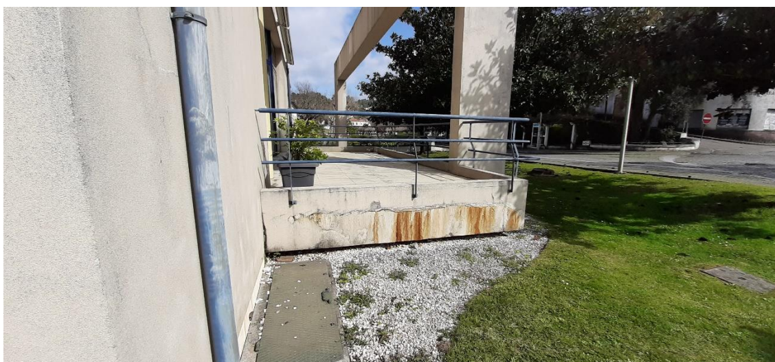
Figura 3.16 – Varanda evidenciado a fissura com escorrência de óxidos
