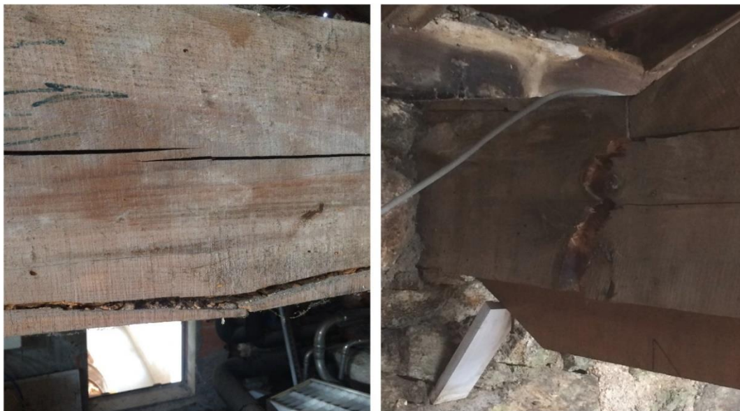
Figura 3.39 – Anomalias nas asnas da cobertura (07/02/2019 – cortesia Eng. Diogo Oliveira)
