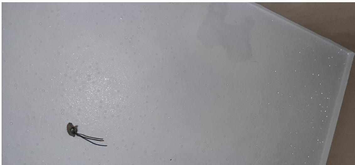
Figura 3.4 – Gotas de água no teto (compartimento de arrumos)
