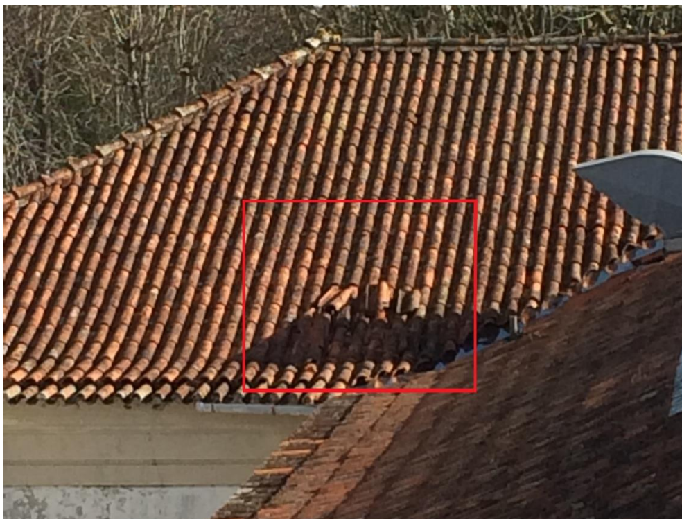
Figura 3.40 – Telhas partidas e mal posicionadas (07/02/2019 – cortesia Eng. Diogo Oliveira)
