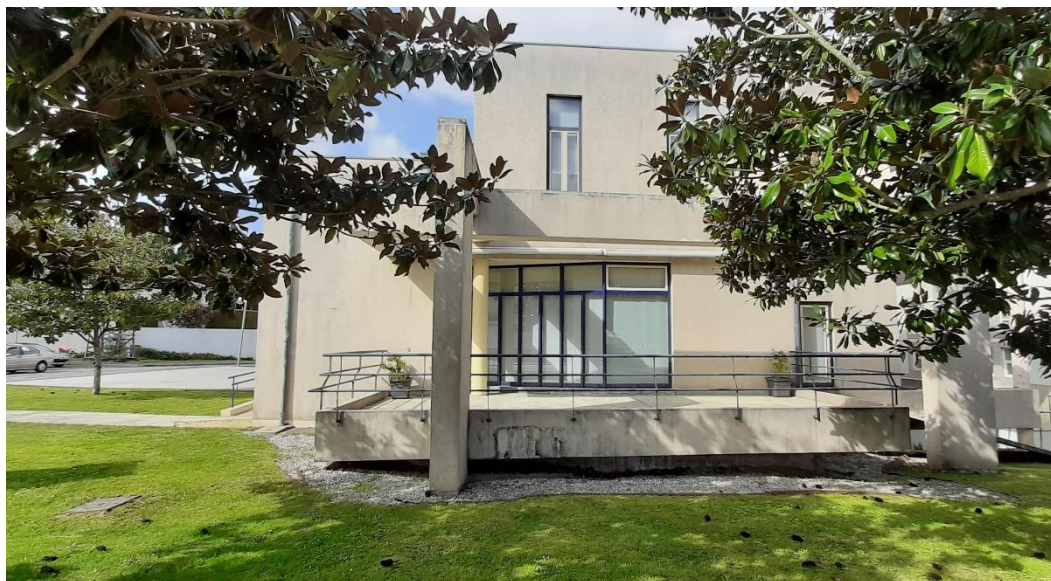
Figura 3.17 – Varanda evidenciado a fissura com escorrência de óxidos
