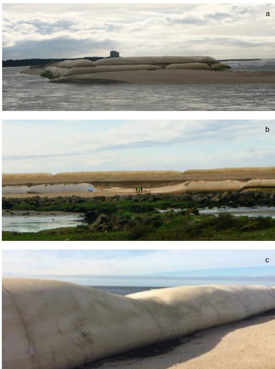
Fig. 48 - Estado do fim da obra e exemplos de problemas encontrados nos geocilindros face aos fenómenos marítimo e fluvial, no início de 2016: a) aspeto da restinga no final da obra de reforço; b) rutura de um geocilindro no lado do rio da restinga; c) migrações de areia no interior do geocilindro, Palma (2016).
