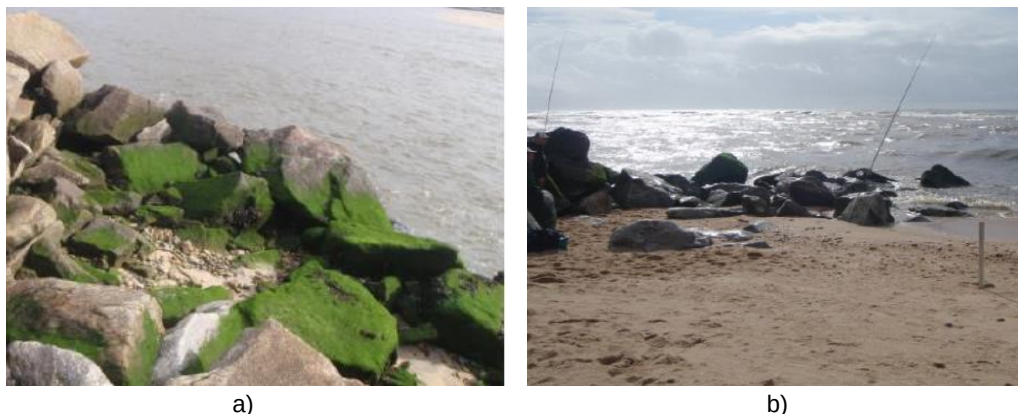
Fig. 50 - Fotografias do molhe Norte da embocadura do rio Cávado evidenciando o estado de degradação da estrutura de enrocamento: a) falhas na estrutura (vista Norte), b) destruição na seção da cabeça (vista Norte), (PLN, 2016b).
