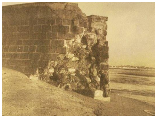
Fig. 23 - Esposende antiga: estado de degradação do paredão da foz (Neiva, 2012).
