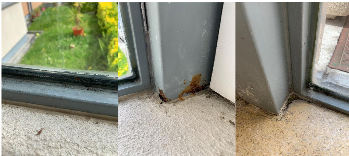
Figura 5.4 - Fotografias de patologias nos elementos envidraçados da caixa de escadas cerca de cinco anos após reabilitação
