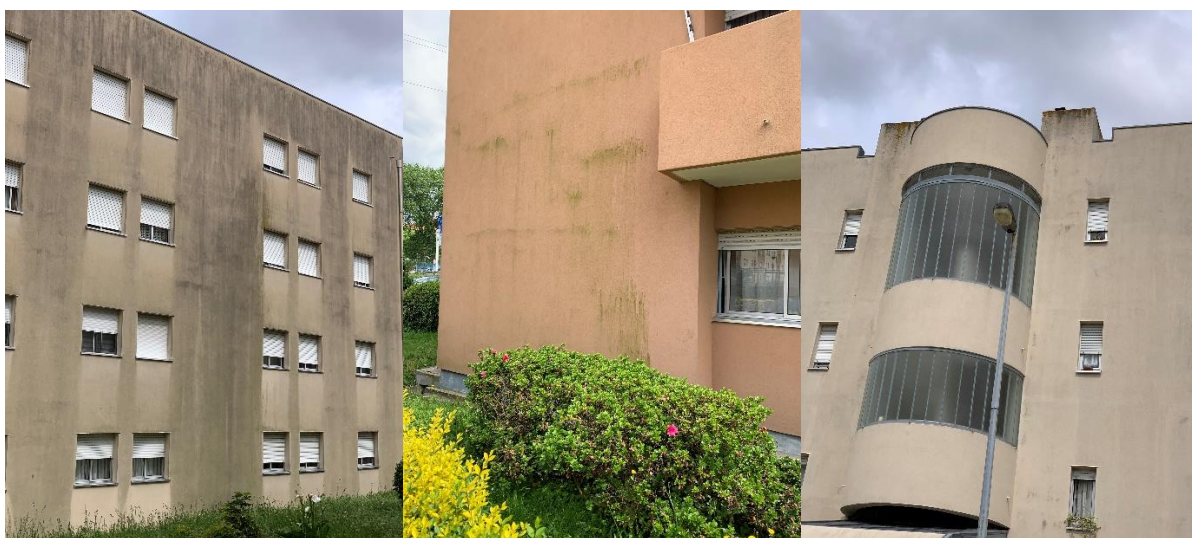
Figura 5.3 - Fotografias de patologias em fachadas exteriores cerca de cinco anos após reabilitação
