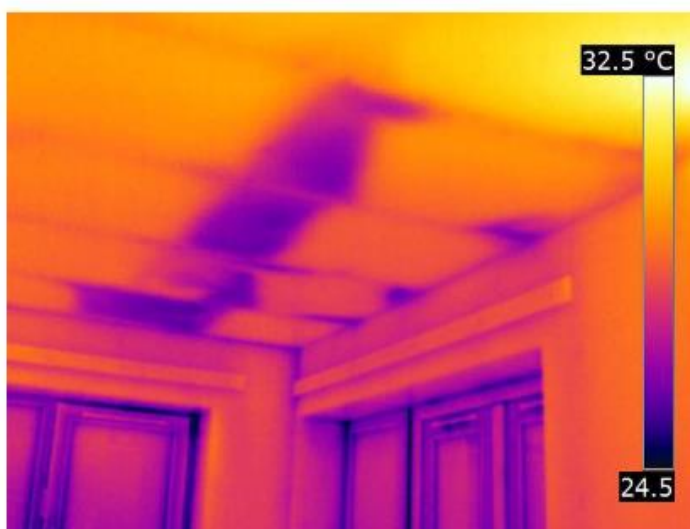
Figura 22 - Manifestação termográfica de isolamento mal aplicado [35].
