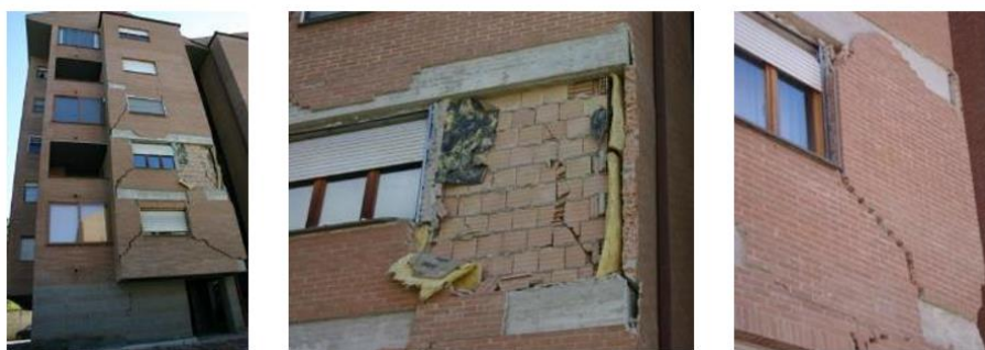
Figura 1.11 - Danos em elementos não estruturais, causados, eventualmente, por fracos apoios, má ligação com os elementos estruturais, falta de amarrações, etc - L'Áquila, Itália, 2009.
