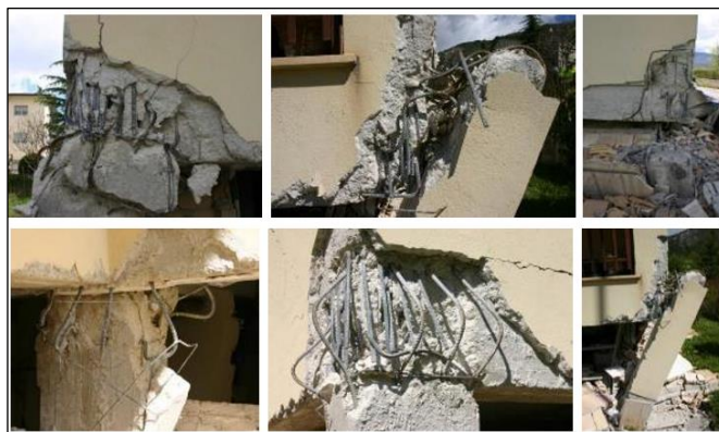
Figura 1.9 - Exemplo de fraca resistência ao corte do nó de ligação – sismo de Petino
