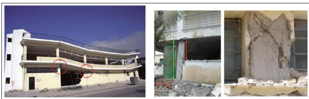
Figura 1.6 Casos de danos causados por pilares curtos
