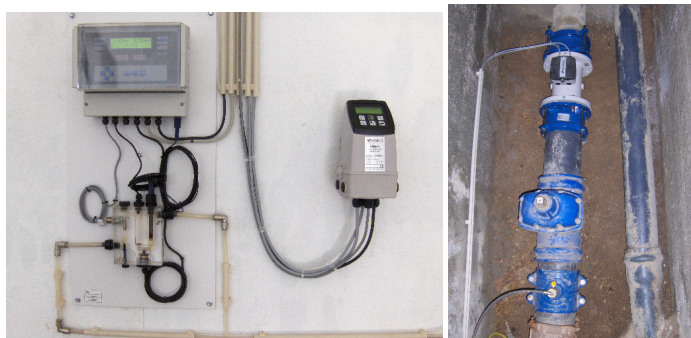
Figura 6.4 - Transdutor pH, Cloro e contador electromagnético de Santa Cruz
