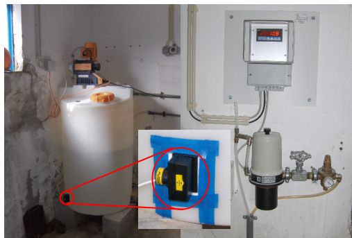
Figura 6.6 - Bomba doseadora de cloro, transdutor de falta de cloro e de turvação
