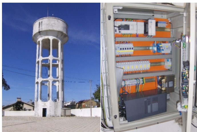
Figura 6.3 - Reservatório de Santa Cruz e quadro de comando
