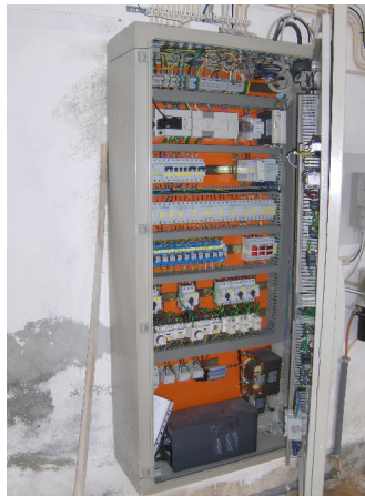
Figura 6.5 - Quadro eléctrico de comando e de potência
