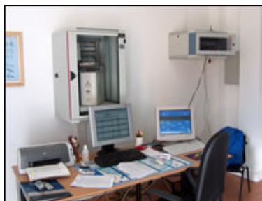
Figura 4.6 - Centro de Comando
