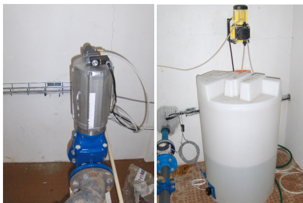
Figura 6.13 - Válvula de cunha, pneumática, depósito de hipoclorito, detector nível mínimo e bomba doseadora
