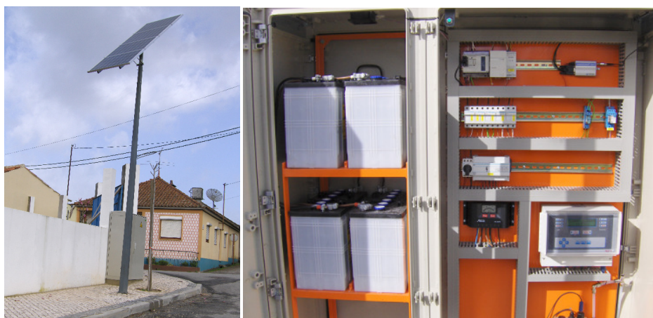
Figura 6.14 – Painel Solar e interior do quadro eléctrico
