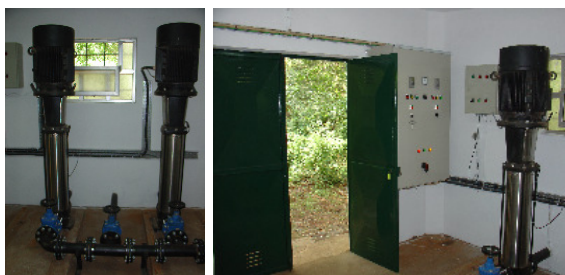
Figura 6.10 - Bombas hidráulicas e quadro eléctrico de comando e de potência de Rendo
