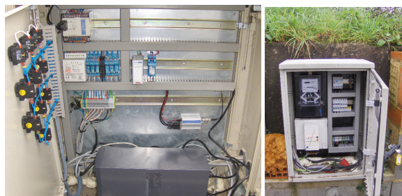
Figura 6.8 - Interior do quadro de comando e de potência das Urgueiras
