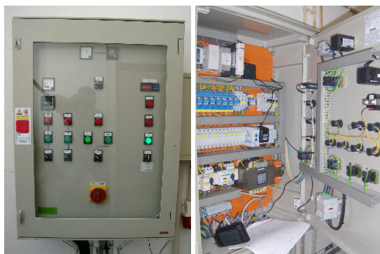
Figura 6.12 - Exterior e interior do quadro eléctrico de São João de Loure
