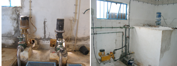
Figura 6.7 - Bombas hidráulicas, depósito de cal, bomba doseadora e agitador
