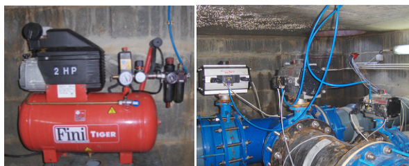
Figura 6.9 - Compressor, purgador e lubrificador e respectivas válvulas
