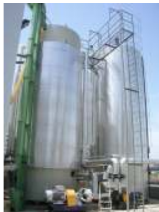
Figura 4.12 – Depósitos de fabrico de BMB na LUSASFAL
