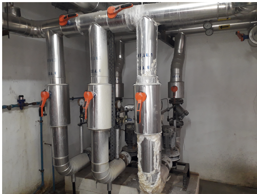
Figura 3.8: Exemplo dos efeitos da corrosão na central térmica do edifício da Talassoterapia (2/3)
