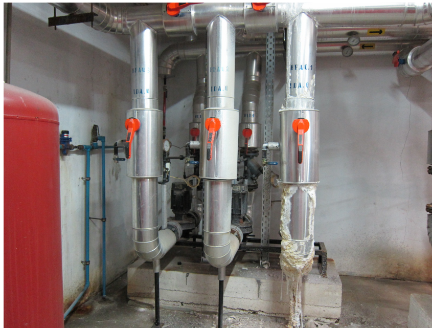
Figura 3.7: Exemplo dos efeitos da corrosão na central térmica do edifício da Talassoterapia (1/3)
