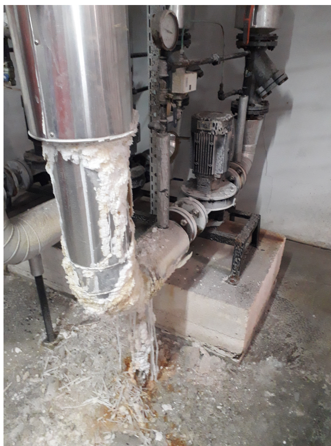
Figura 3.9: Exemplo dos efeitos da corrosão na central térmica do edifício da Talassoterapia (3/3)
