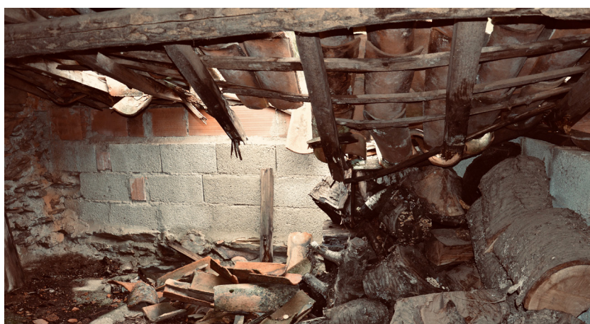
73 Quebra na estrutura debilitada
