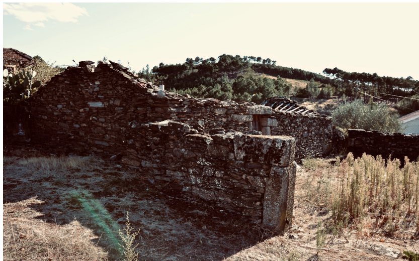
23 Pátio e estruturas de cobertura colapsadas, Quinta da Macieirinha
