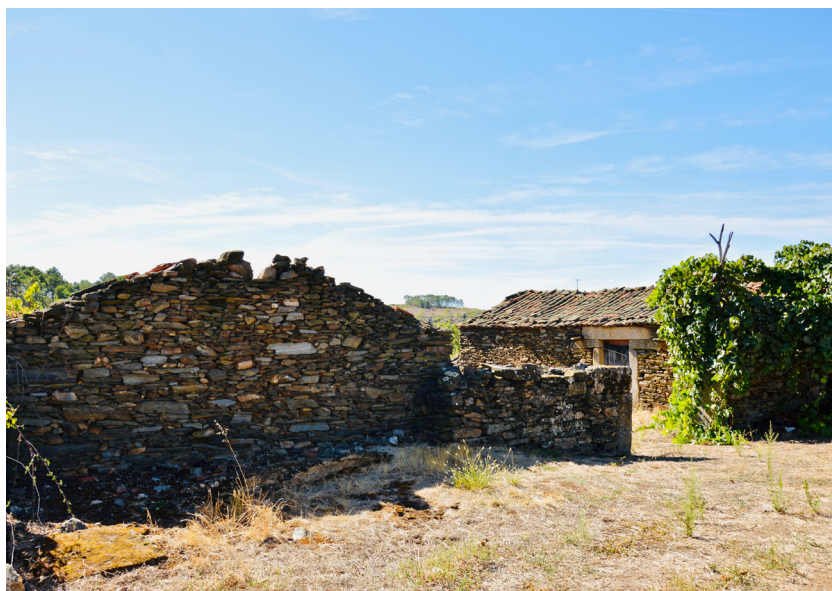
22 Volumetria e estruturas de cobertura colapsadas, Quinta da Macieirinha
