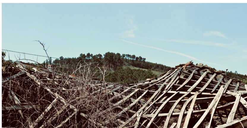
3.d Estrutura de cobertura tombada, Quinta da Macieirinha
