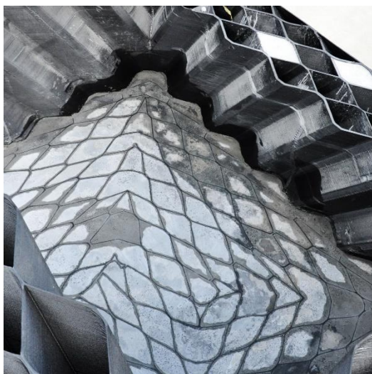
Figura 4.31 – Pormenor em que é possível ver a gralha no interior das paredes, assim como o reforço de algumas zonas com betão.
