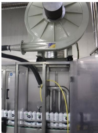
Figura 3.14 - Sopradores à saída do banho
