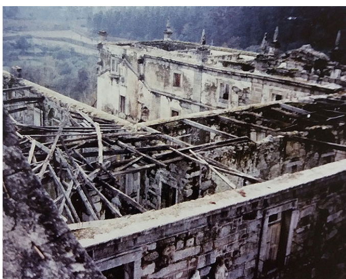
178. Pormenor do antigo Mosteiro – o telhado arruinado.
