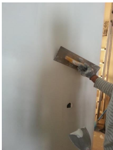
Fig. 3.22 - "Barramento geral" em parede de gesso cartonado
