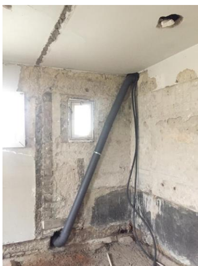
Fig. 3.19 - Tubagem de águas negras
