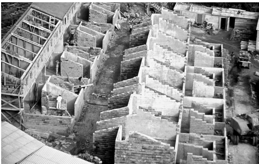
Fig. 34. Construção do Bairro das Antas, Porto, 1975. O Bairro também resulta do FFH e da Operação SAAL.
