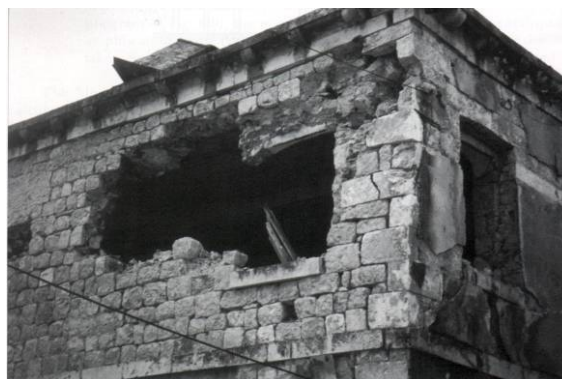
Fig. 2.35 Colapso de uma alvenaria de pedra irregular com argamassa de baixa qualidade.
