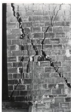
Fig. 2.34 Fendas em paredes constituídas por elementos regulares.
