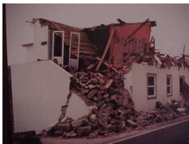
Fig. 2.40 Colapso dos cantos
