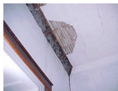
c) Deslocamento da parede
