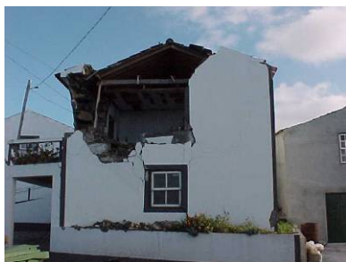
Fig. 2.39 Colapso de uma das empenas
