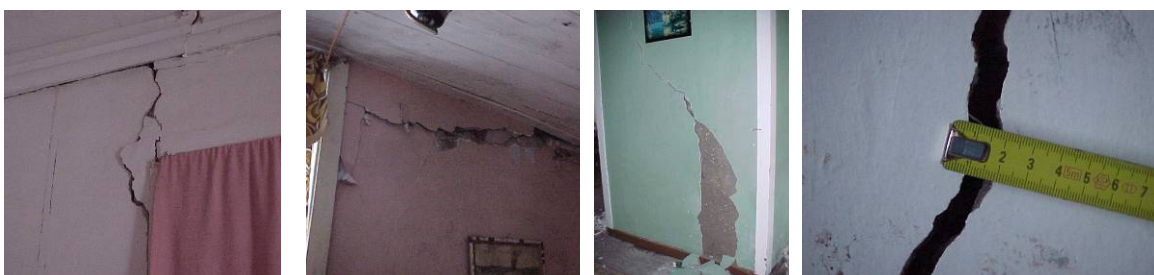
Fig. 2.43 Patologias observadas no interior das casas
