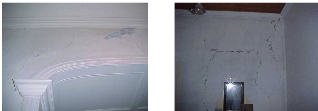
Fig. 2.45 Fissuração e destacamento do reboco nas paredes-mestras interiores
