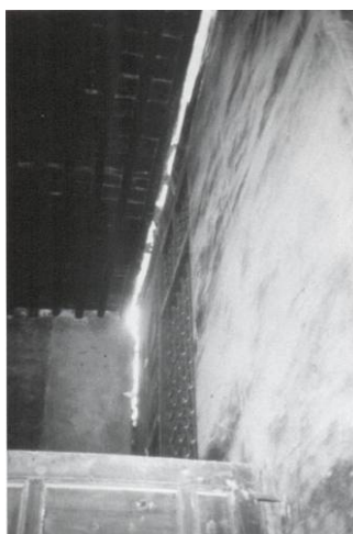
Fig. 2.38 Destacamento dos elementos estruturais
