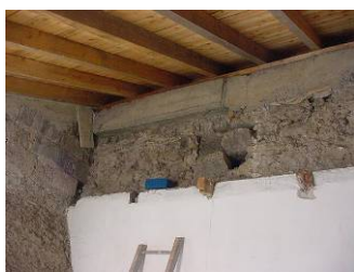
a) Inexistência do 2º piso
