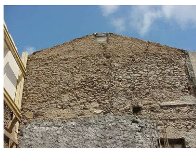
Fig. 2.8 Paredes em zonas urbanas com má qualidade
