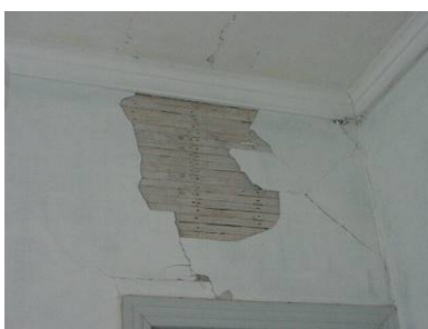
b) Destacamento do reboco
