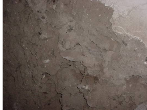
Fig. 5.31- Casa nº 15 – Parede meeira direita – zona superior
