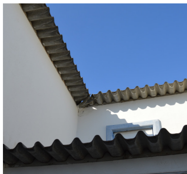
Figura 17 - Pormenor de telhas em fibrocimento.
