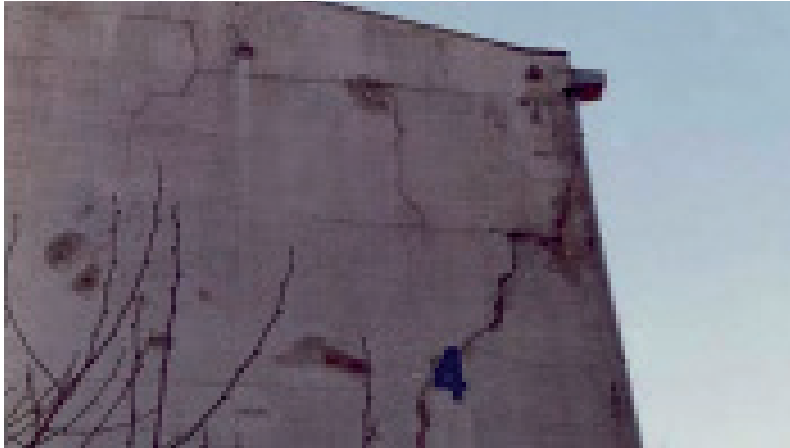
Figura 61: Exemplo de fissuras na empena Bairro do Calvário
