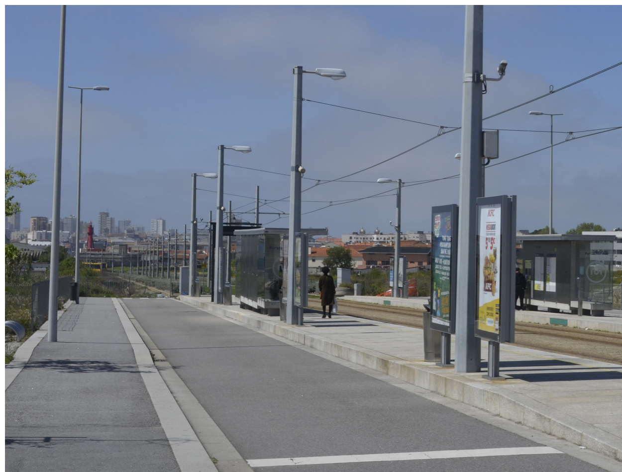
1110. Via de asfalto "morre" no fim do lajeado de granito, pode-se também ver a quebra nos bancos do abrigo
