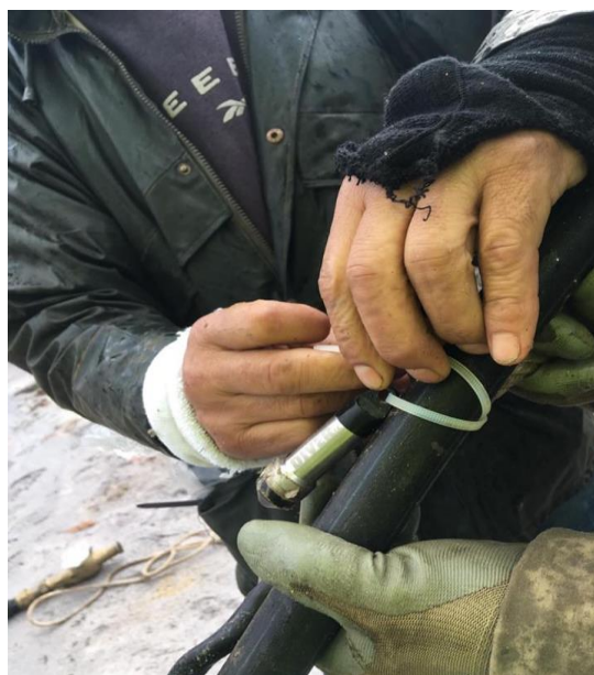
Figura 4: Colocação de Sonda automática na bomba
