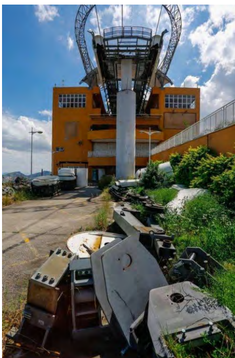
Figura 71: Estação de teleférico do Morro do Adeus em situação de abandono.
