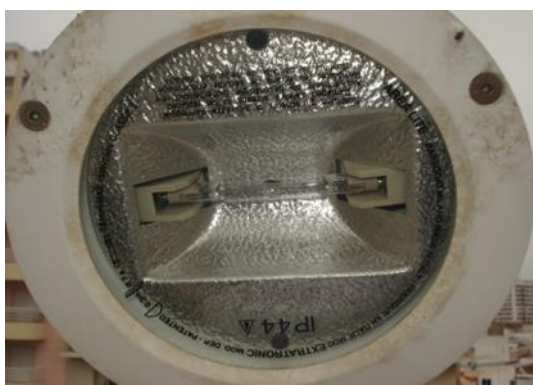
Foto 17: Iluminação exterior na fachada
