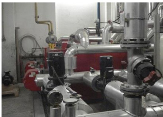
Foto 19: Caldeiras e queimadores
