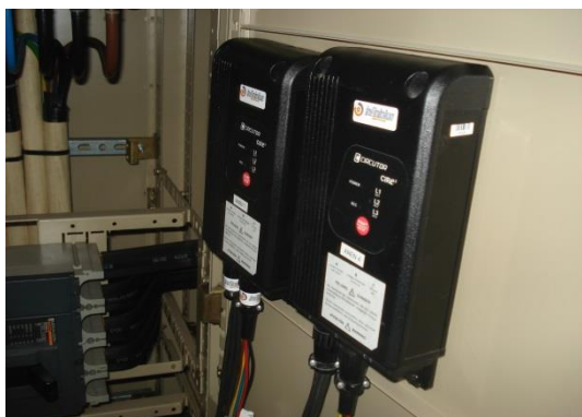
Foto 29: Medição do Quadro Geral
