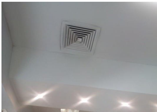
Foto 23: Sistema de difusão – Difusor de insuflação de 4 vias
