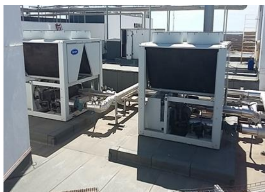
Foto 18: Chillers (duas unidades) instalados na cobertura
