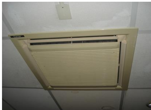
Foto 24: Unidade interior - ventiloinvencor do tipo cassette
