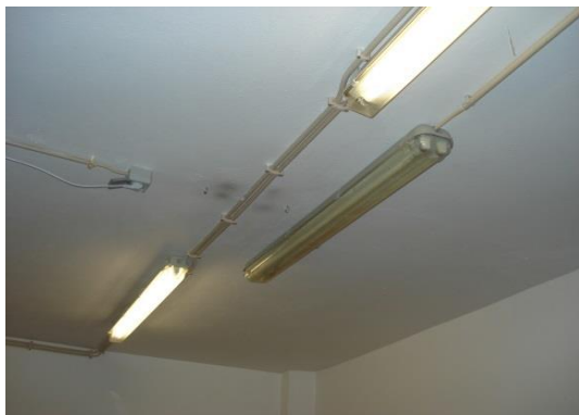
Foto 15: Iluminação – fluorescente tubular
