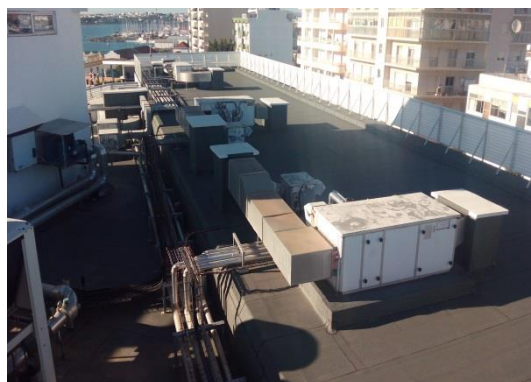
Foto 20: Vista do posicionamento de UTAN's e respetivos ventiladores de extração
