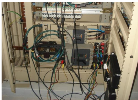
Foto 30: Medição de outros quadros elétricos parciais
