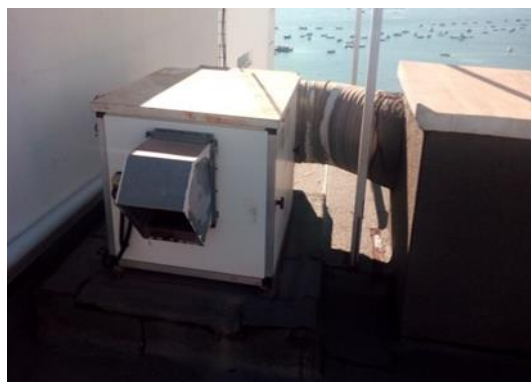
Foto 22: Ventilador de extração (prumada de instalações sanitárias)
