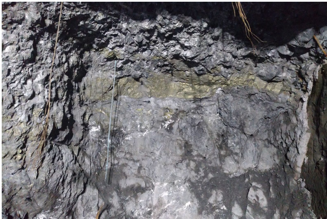
Ilustração 22 - Fissural de cobre da Frente 1
