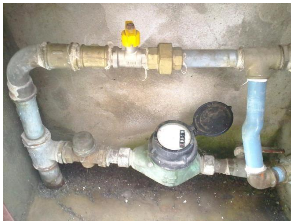
Figura 27 - “Bypass” ao contador.
