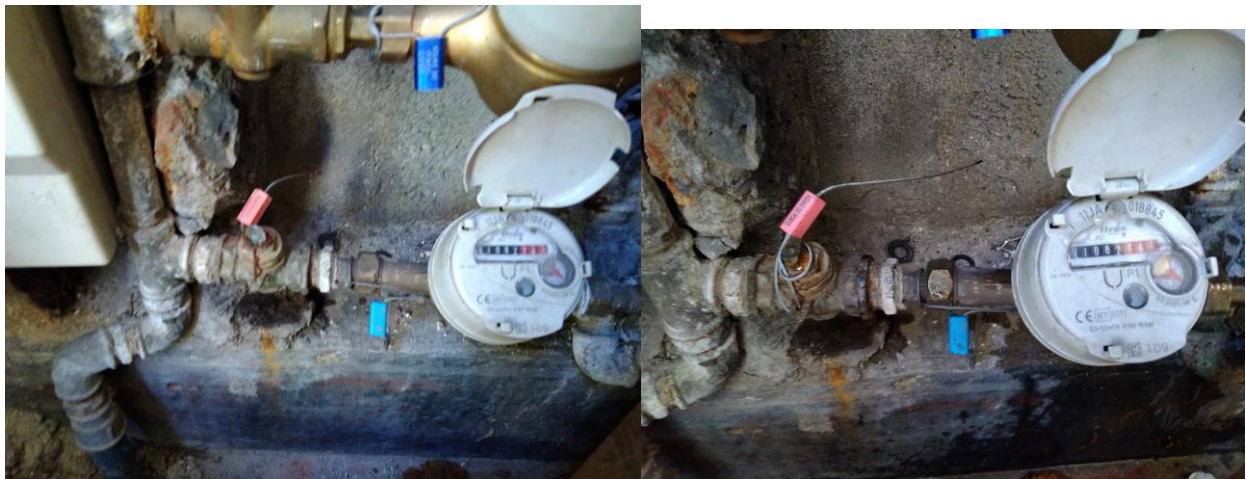
Figura 55 - Abertura abusiva e selo enferrujado
