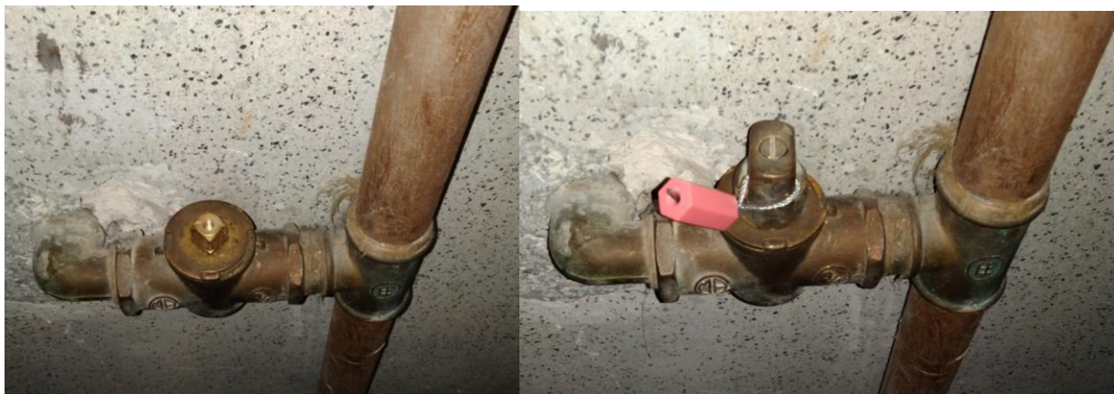
Figura 53 - Selo de corte removido
