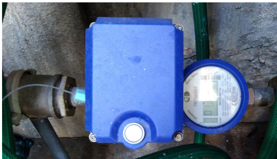
Figura 42 - Contador inteligente, instalado pelas AdP, numa instalação piloto
