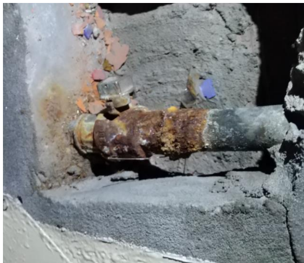
Figura 37 - Adufa enferrujada e sujeita e rotura.
