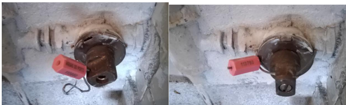
Figura 52 - Selo de corte violado
