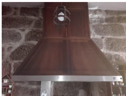
Fig.3.7 Exaustor Individual da Cozinha
