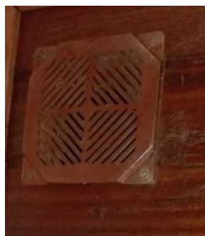
Fig.3 2 Grelha de Exaustão Natural da casa de banho
