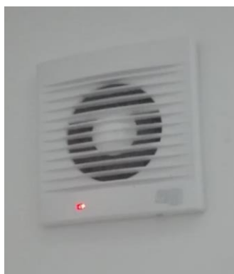
Fig. 3.10-Grelha de ventilação da casa de banho com sistema mecânico controlado
