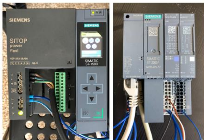
Figura 4.2 Fonte de alimentação, CPU e Módulo de sinal de entrada utilizado.
