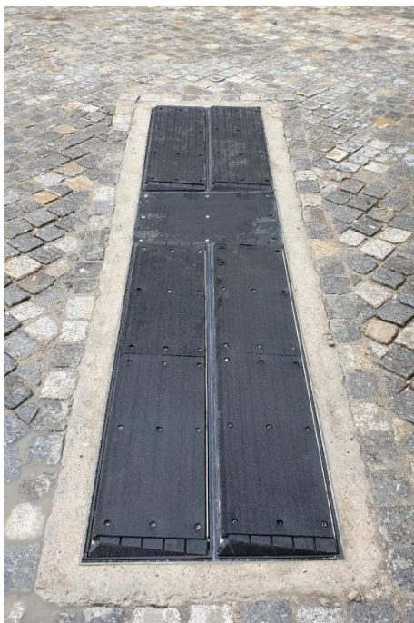
Figura 35 - Protótipo do sistema PEH totalmente instalado, em Matosinhos
