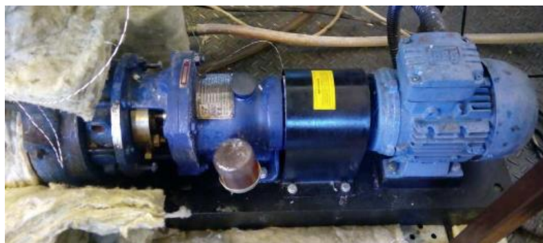
Figura 3.5 – Grupo de bombagem (Trindade, 2018).
