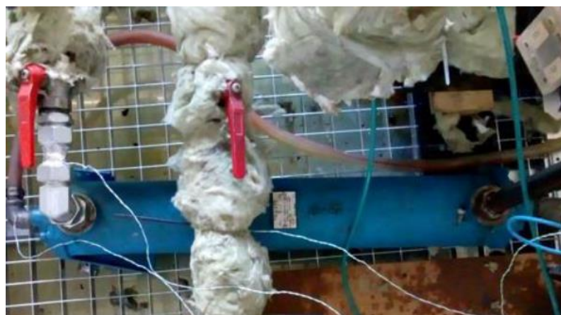
Figura 3.3 -Permutador de calor (Rocha, 2018).
