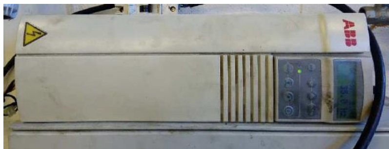
Figura 3.6 – Variador de frequência (Trindade, 2018).
