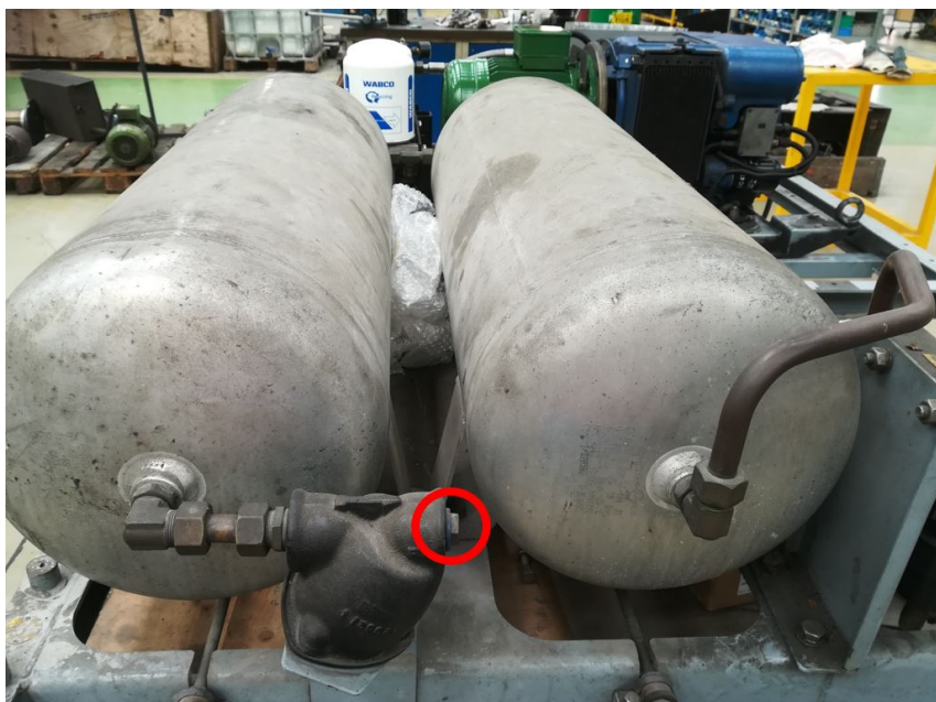
Figura 5.11: Local onde será colocado o transdutor de pressão que monitoriza a pressão do painel pneumático.
