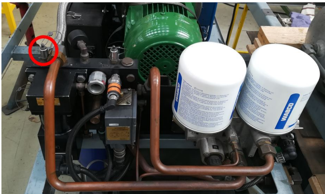
Figura 5.8: Local onde será colocado o transdutor de pressão que monitoriza a pressão do compressor.
