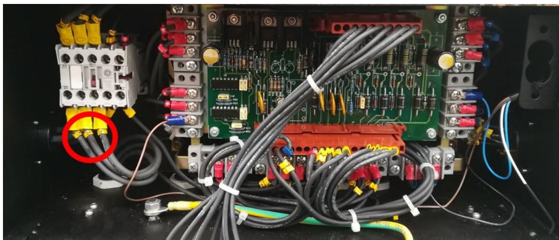
Figura 5.3: Local da caixa da carta eletrónica onde se encontram os 3 cabos correspondentes às 3 fases do motor trifásico.
