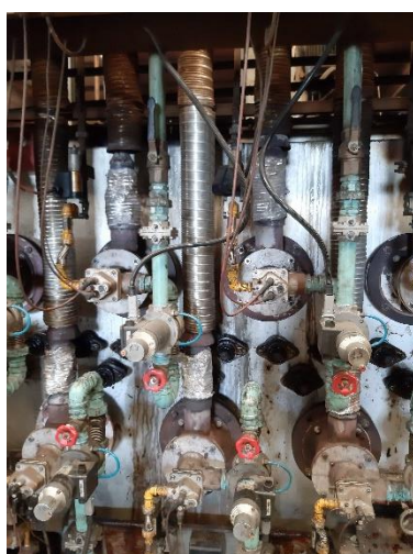
Figura 11 - Tubos de exaustão.
