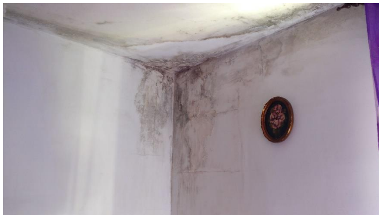
Figura 5.37- Caso de humidade/infiltrações nas habitações
