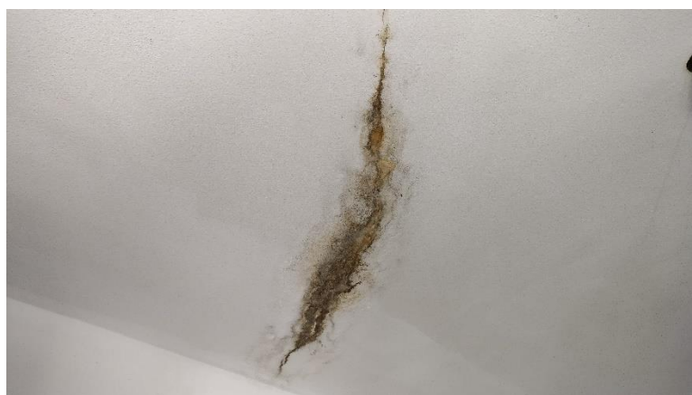
Figura 5.38- Caso de humidade/infiltrações nas habitações
