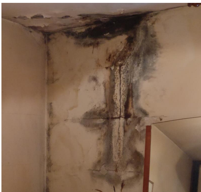
Figura 5.39- Caso de humidade/infiltrações nas habitações
