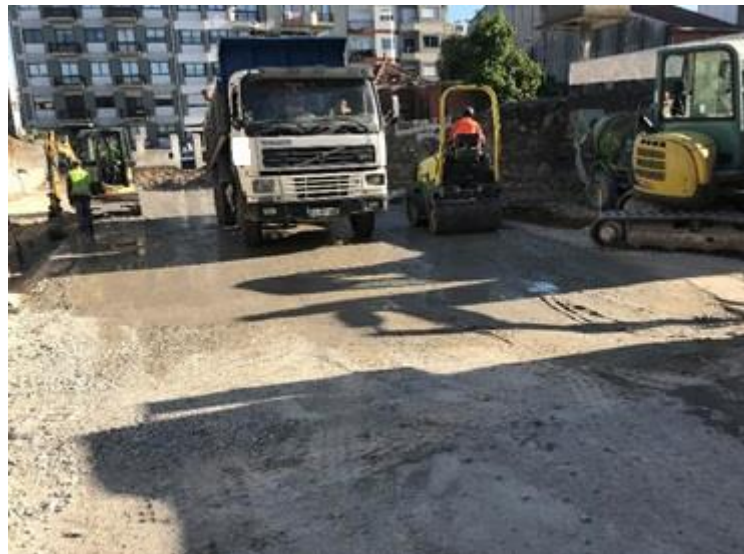
Fig.3.14. – Falta de espaço de estaleiro com 2 frentes de trabalho na mesma zona
