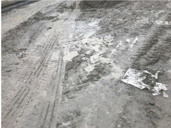
Fig.3.17. – Estragos causados pela chuva
