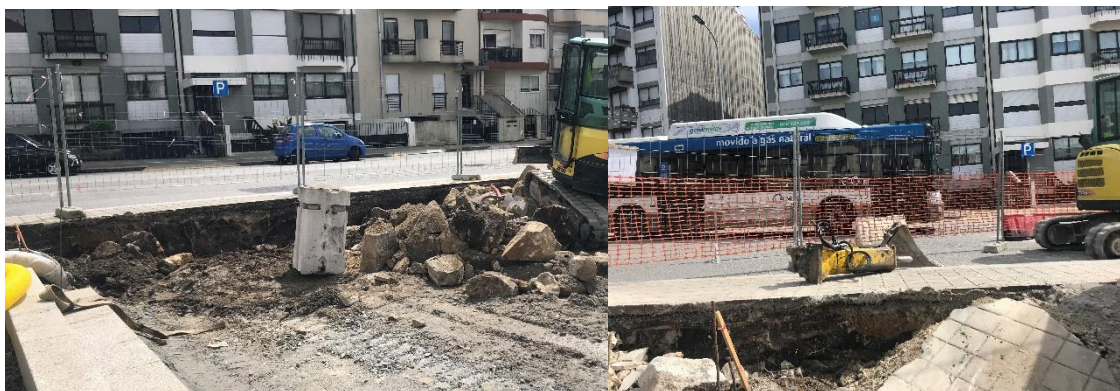
Fig.3.18. – Falta de privacidade provocada pela vedação
