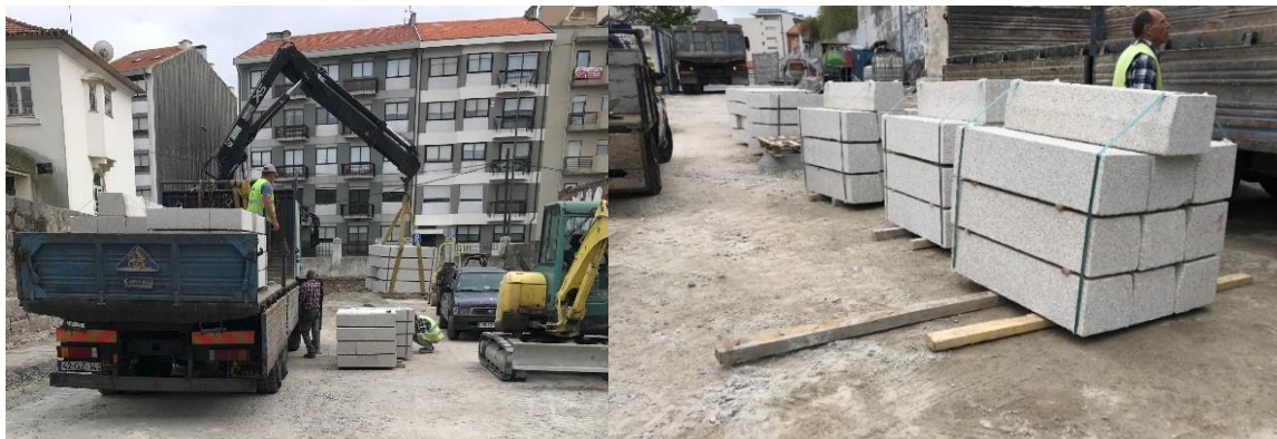
Fig.3.16. – Falta de espaço de armazenamento de materiais
