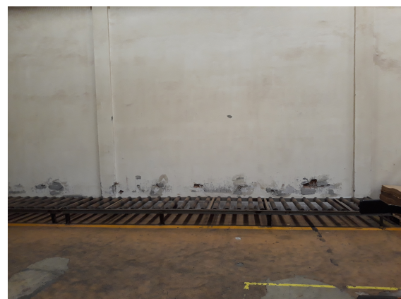
(d) Parede danificada devido ao choque com os garfos do empilhador.
