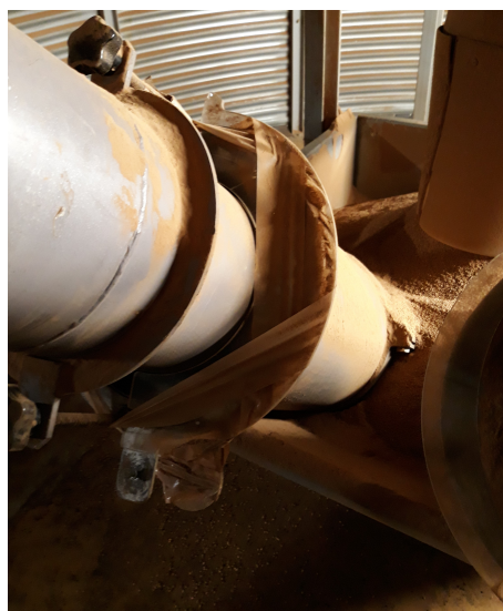
(c) Sistema de controlo do fluxo aspirado.
