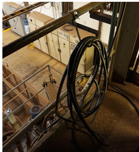
(b) Mangueira de ar comprimido de capacidade insuficiente.
