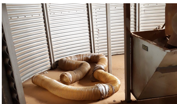
(a) Mangueira de transporte deteriorada.
