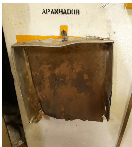
(a) Apanhador em mau estado de conservação.
