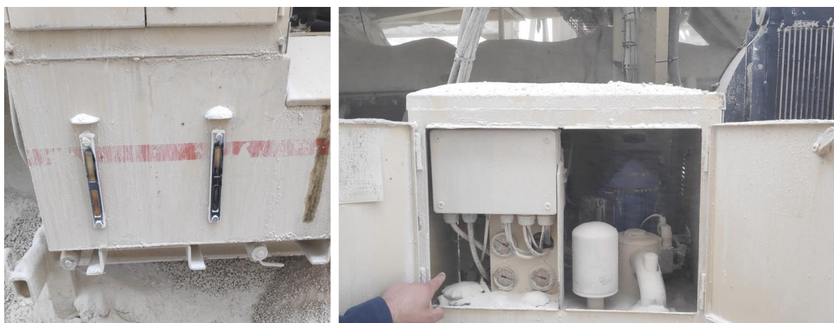
Figura 25 - Estado inicial do grupo de lubrificação (à esquerda) e do grupo hidráulico à (direita)
