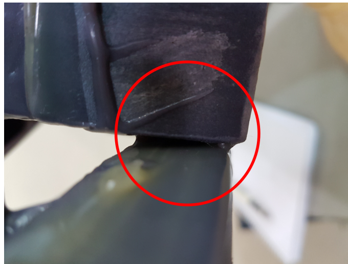
Figura 2.13: Junta com falta de cera cola
