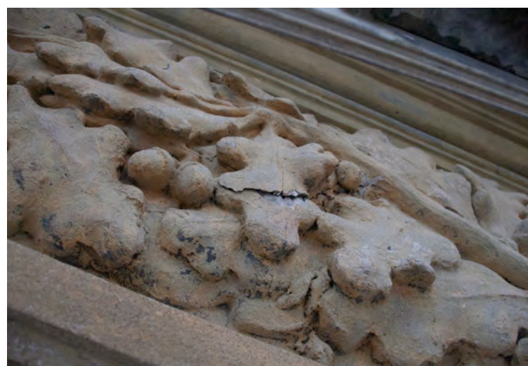
Figura 05 – Estado de conservação da Envolvente Exterior. Fonte: Autores, 2014
