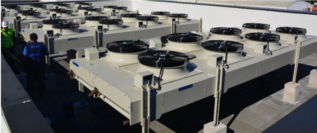
Figura 15 – Conjunto de condensadores a ar montados numa obra de grande dimensão [30].
