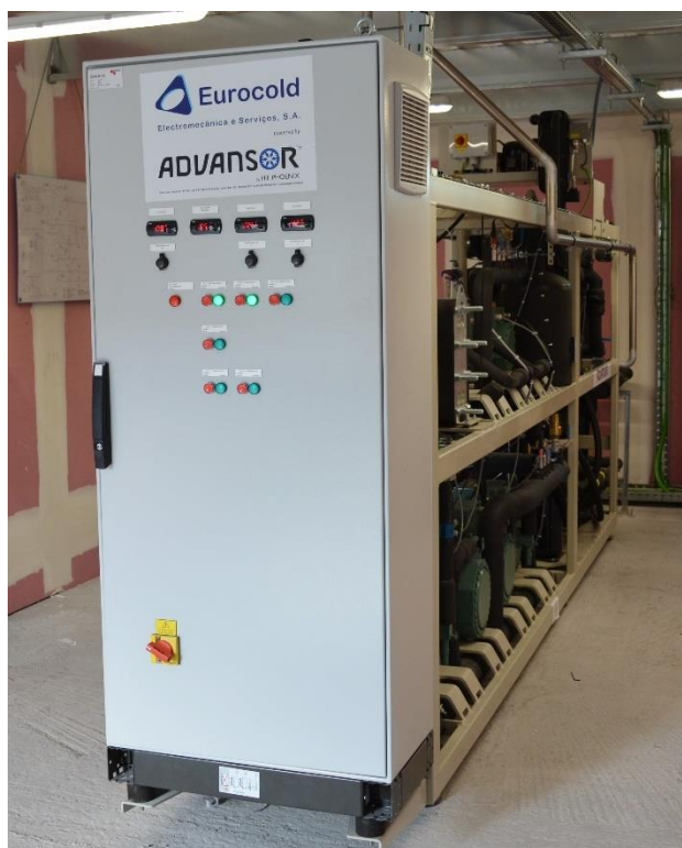
Figura 39 - Central SuperComp Sigma instalada na casa de máquinas.
