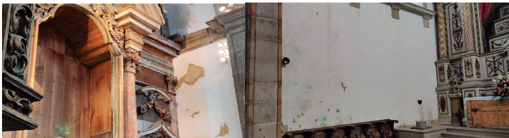
Fig. 5.5 – Infiltrações nas paredes do CI
