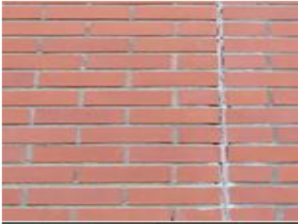
Deterioração da vedação da junta de dilatação
