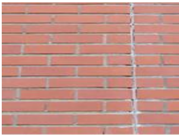
Fig.41 – Representação fotográfica da anomalia tipo “ Deterioração da vedação das juntas”.
