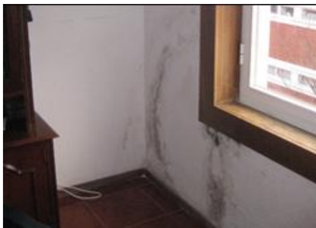
Fig.37 – Representação fotográfica da anomalia tipo “Sinais de presença de água”.
