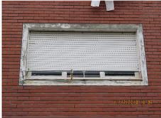
Descasque da pintura dos vãos da janela
