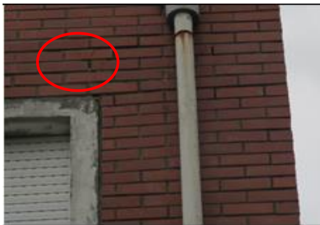
Fissura na fachada exterior junto ao vão da janela
