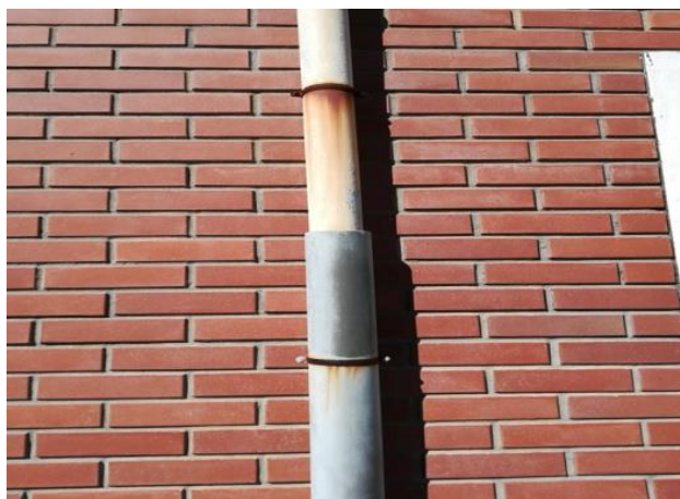
Fig.34 – Representação fotográfica da anomalia tipo "Fenómenos de corrosão".
