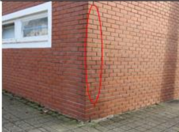
Fissuração da parede exterior na zona do cunhal
