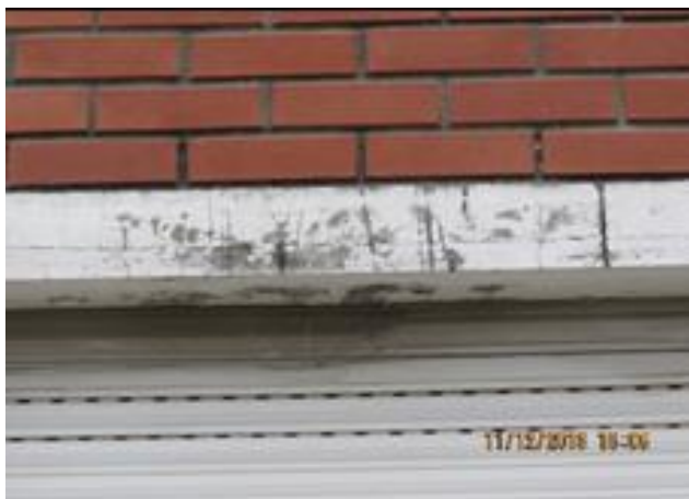
Fissuração das peças de betão armado nos vãos das janelas
