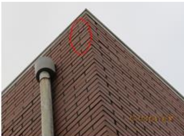
Fissura na fachada exterior na zona do cunhal junto à cobertura
