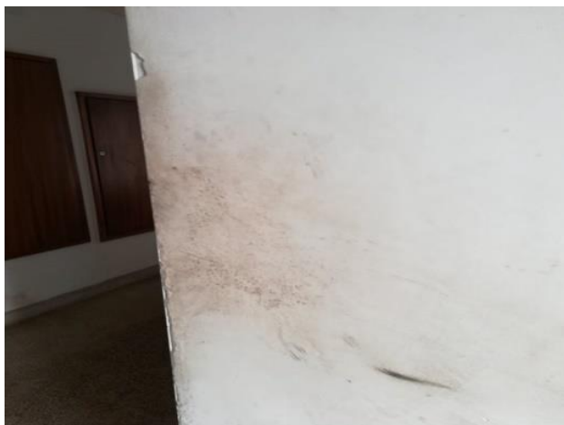
Sujidade existente na parede interior no R/C
