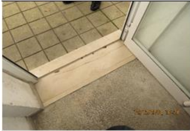
Fissuração da soleira da porta de entrada do edifício
