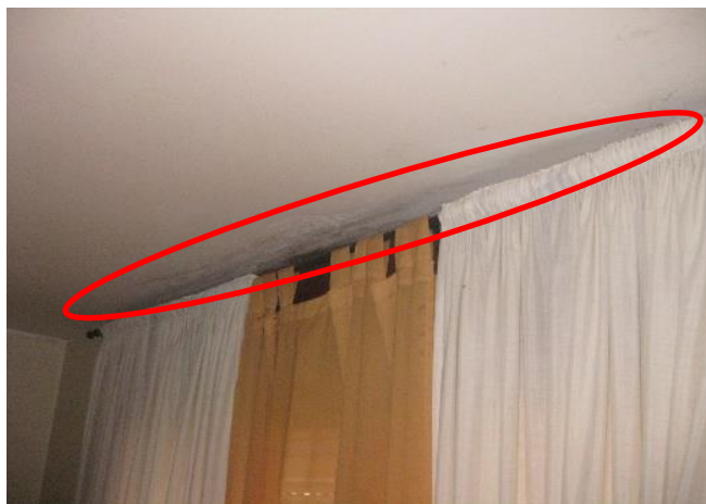
Sinais de presença de água no tecto do quarto 1 junto ao vão da janela
