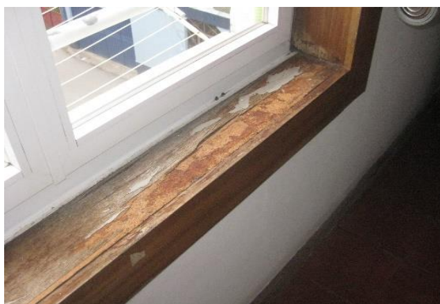
Fig.38 – Representação fotográfica da anomalia tipo “Empolamentos nos apanelados de madeira”.
