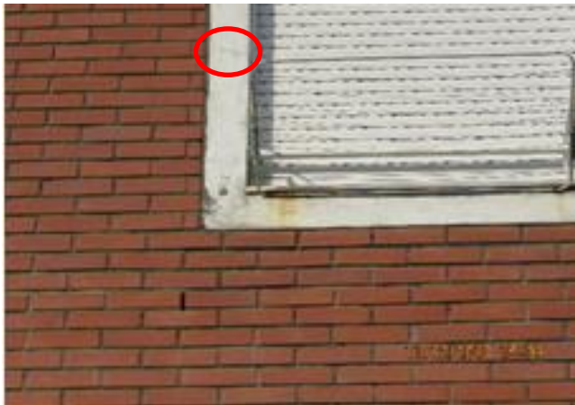
Fissuração das peças de betão armado nos vãos das janelas
