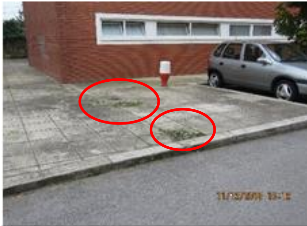
Abatimento do pavimento da envolvente exterior
