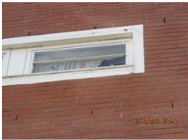
Fig.33 – Representação fotográfica da anomalia tipo "Fissuração".
