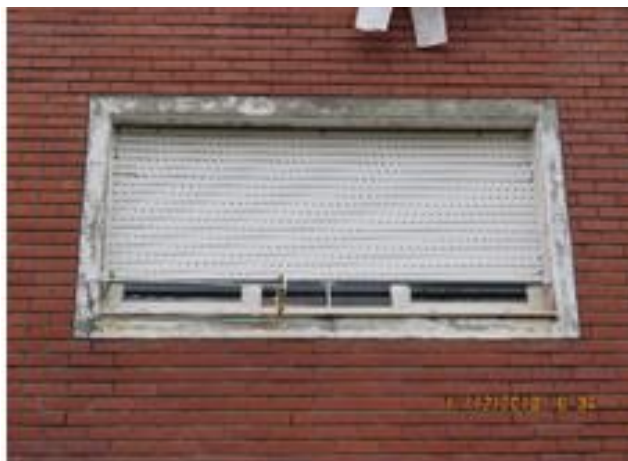
Fig.36 – Representação fotográfica da anomalia tipo “Descasque da pintura”.
