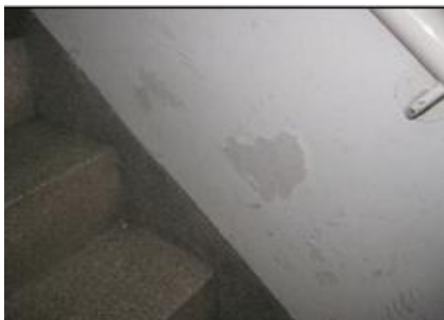
Descasque da pintura da parede interior da caixa de escadas
