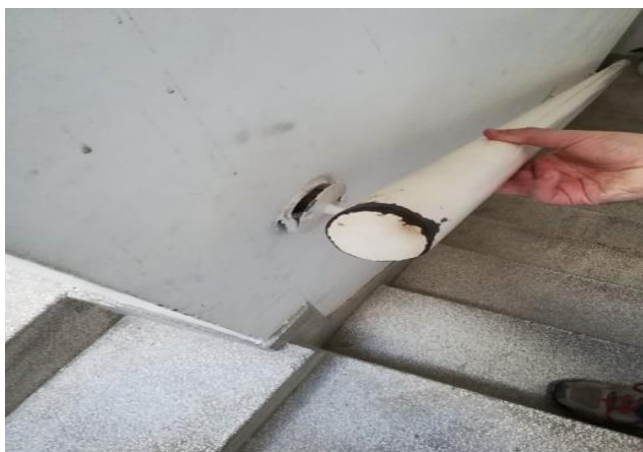
Deterioração do sistema de fixação do corrimão à parede
