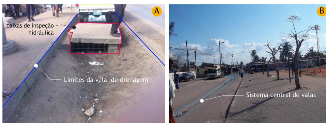
Figura 34: Sistemas de drenagem de águas pluviais no BGD
