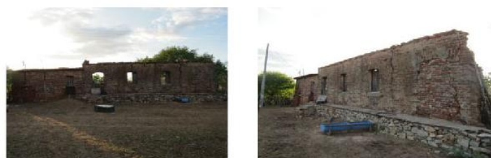
Fachada principal da Casa-grande Arroz em arruinamento
