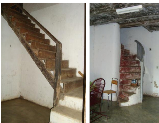
Figura 64. Escadas com modificações. Fonte: Adaptação da autora (2019) a partir de imagens do arquivo do relatório técnico (Assunção, Oliveira, & Silva, 2010)
