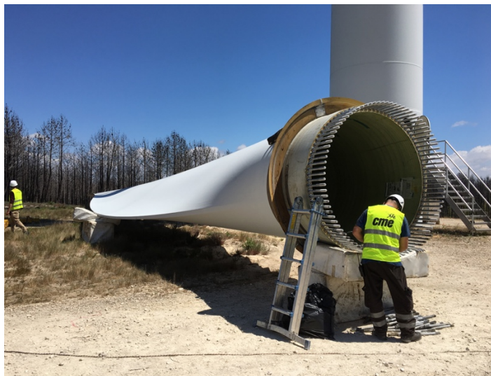
Fig. 5.3- Exemplo de manutenção que ocorreu nas pás no mês de Maio no Parque eólico da Tocha.
