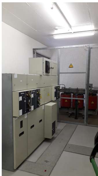
Figura 2.3: Normabloco e respectivo transformador seco em serviço, PC Caniçada
