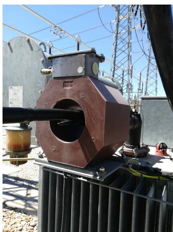
Figura 2.2: Transformador de Intensidade toroidal, SE Valpaços
