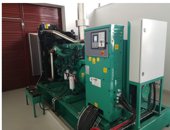
Figura 2.4: Grupo Eletrogéneo de Socorro, SE Palmela
