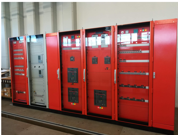
Figura 2.5: Quadro Geral de Corrente Alternada, SE Palmela
