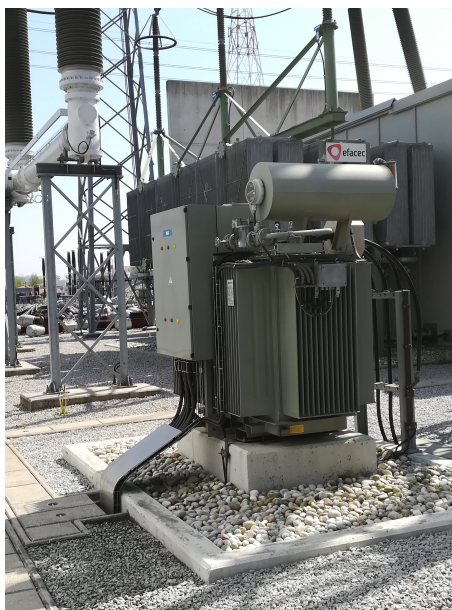
Figura 2.1: Transformador de Serviços Auxiliares, SE Vermoim
