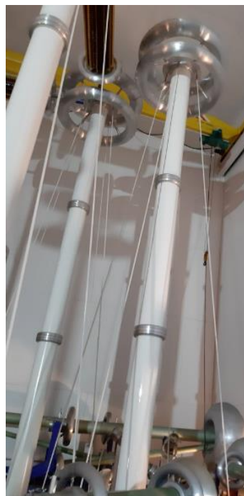
Figura 3.2 - Filtro de Alta Tensão
