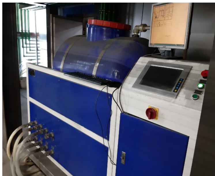
Figura 3.18 - Equipamento que controla e monitoriza o circuito hidráulico
