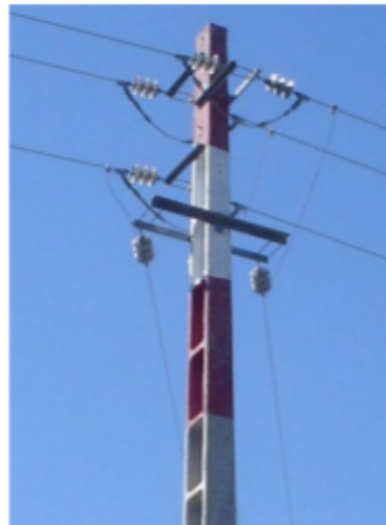
Figura 2.13: Sinalização diurna de um apoio [4].
