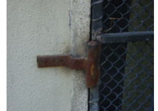
Figura 3.5 Corrosão de elementos metálicos. Hospital da Lapa. 2002.
